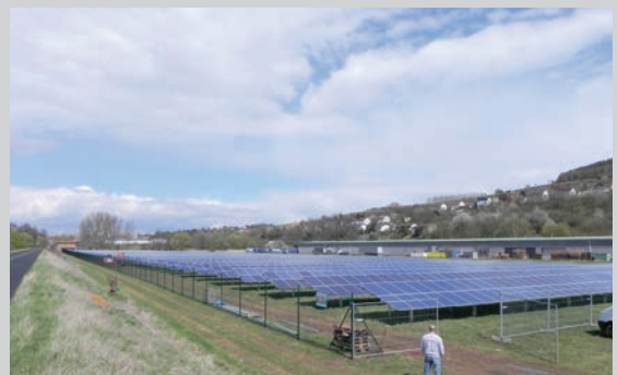
1,3 MW Solarpark Heringen Germany
