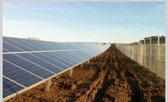
1,8 MW Solarpark Großenlüder Germany
