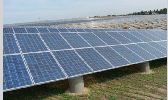
5,4 MW Solarpark Zeitz Nordstraße 10 06712 Zeitz (Germany)
