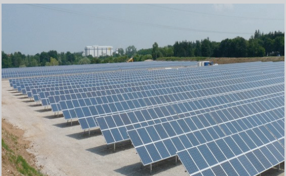
1,3 MW Solarpark Bad Wörishofen Germany
